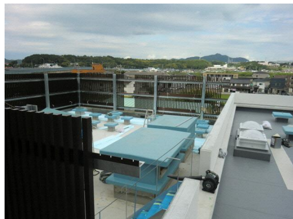
屋上機械基礎 目隠しフェンス
