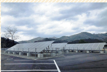
北陵地域公民館の太陽光発電設備
