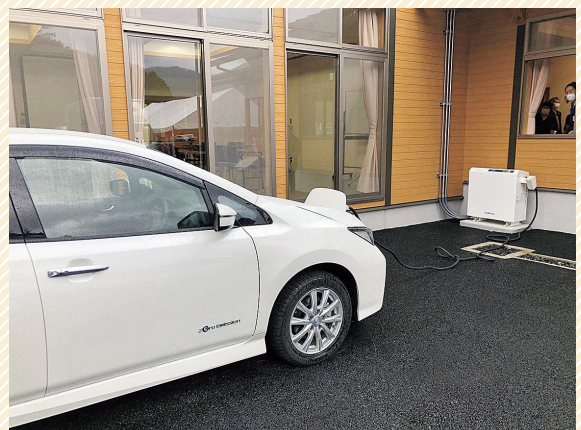
電気自動車とV2B(充放電設備)
