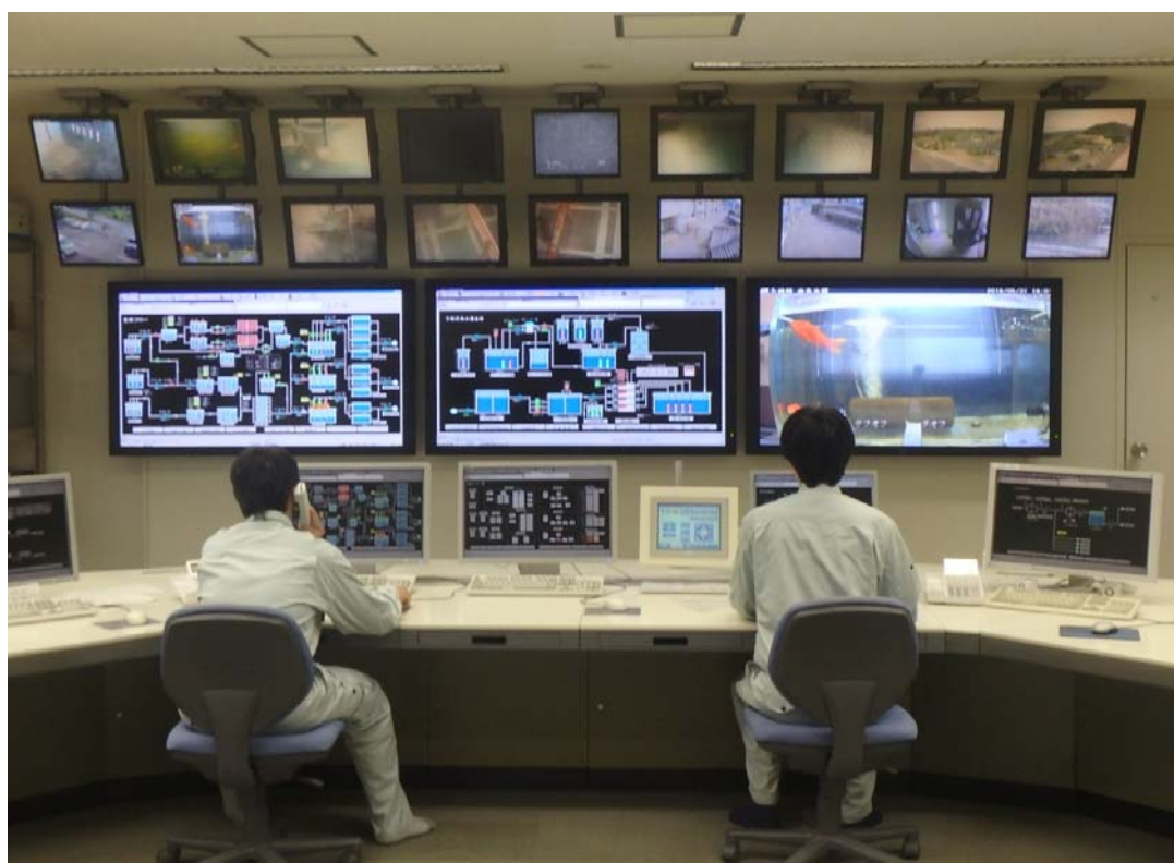
集中監視システム
