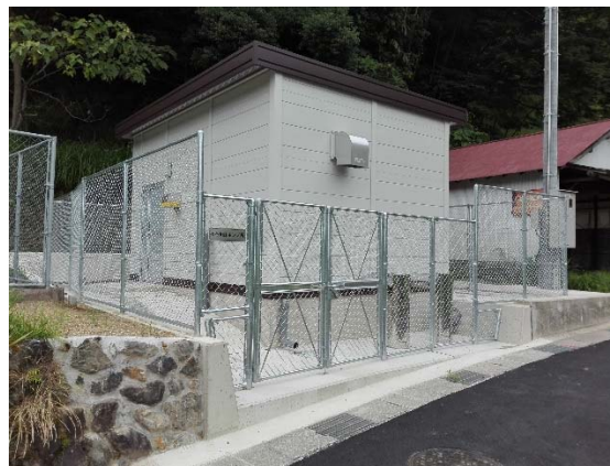
橋谷加圧ポンプ所
