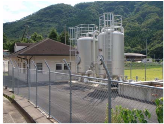
芦洲原水調整棟
