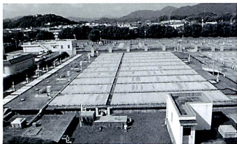
最初沈殿池/臭気対策として蓋を設置しています。
