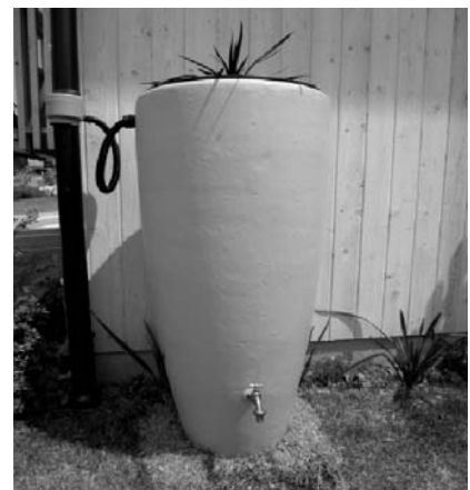
ゆらのガーデン内に設置した雨水貯留槽
