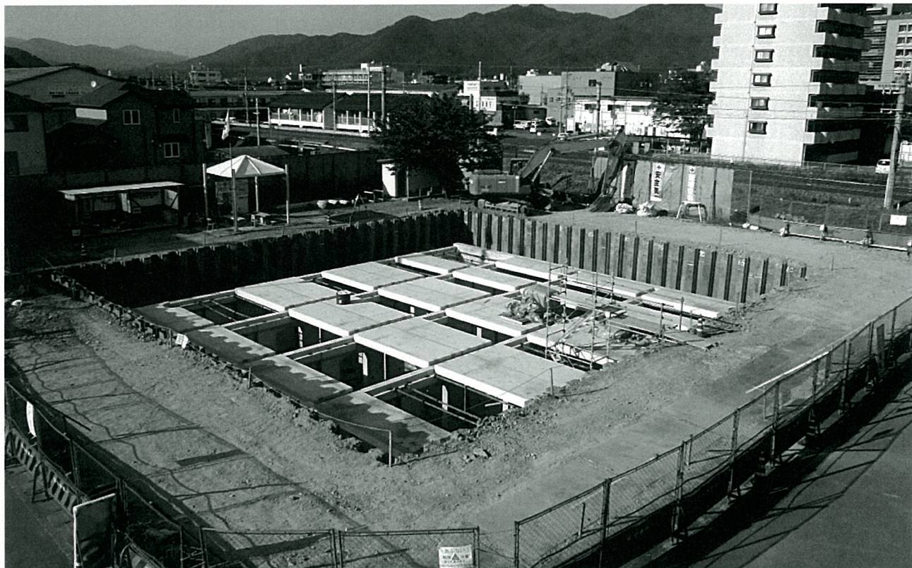
篠尾新町 仲ノ坪北公園地下の雨水貯留施設築造(平成24年度完成)
