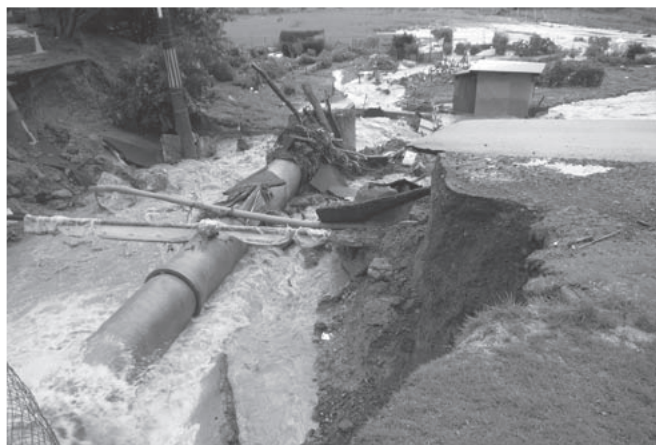
東岡(釜戸)地内 水道管・下水道管が露出(8月17日8時ごろ)
