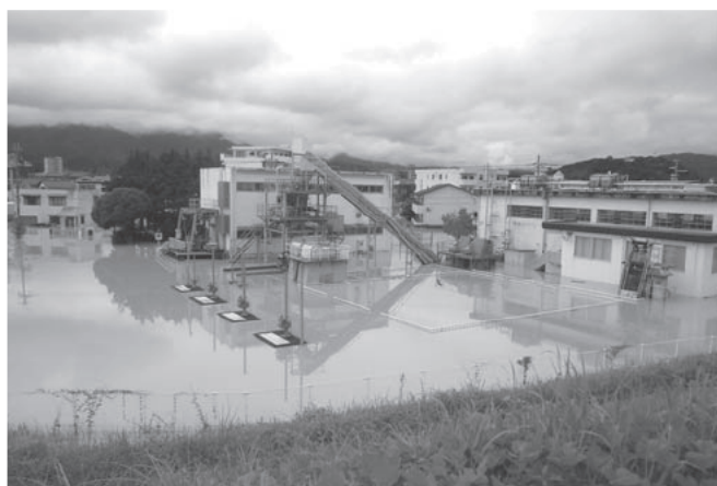
和久市ポンプ場の浸水状況(8月17日11時ごろ)
