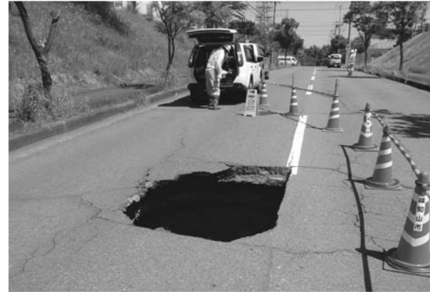
H27.5長田野町 管渠破損による道路陥没事故
