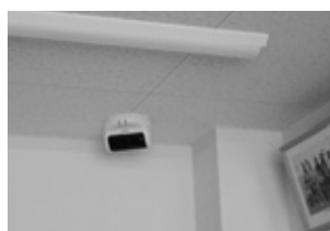
防犯カメラの設置状況
