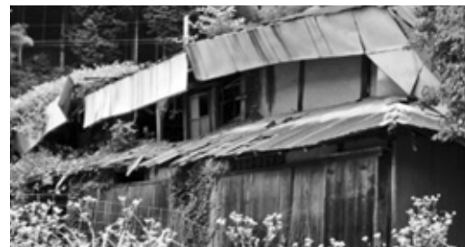
長年放置されて崩壊する空き家
