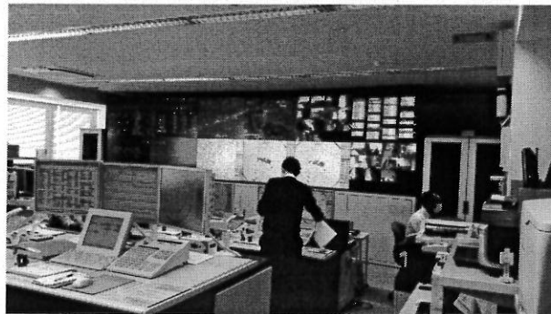
通信指令室の様子
