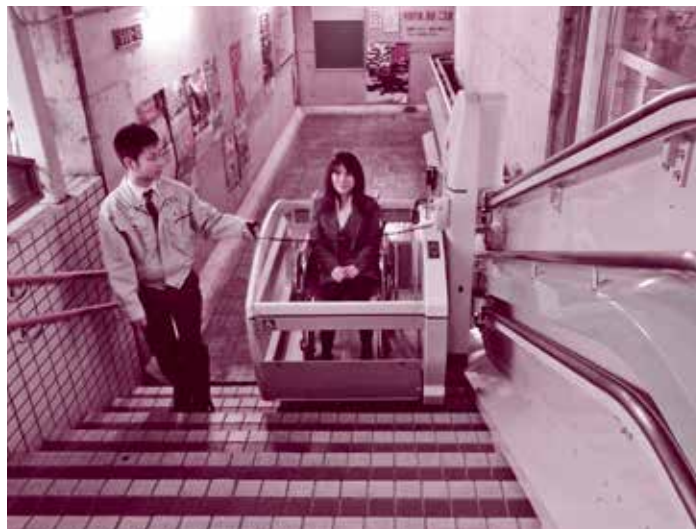
大江駅の階段昇降機 車椅子のまま使用できます。
