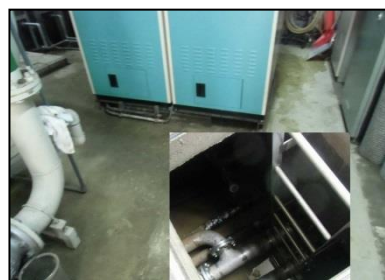
温水プール地下ポンプ等施設
