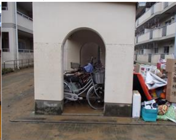
堀口団地被災状況
