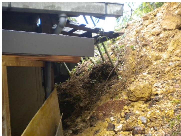
林地被災状況
