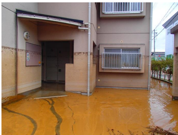
岡ノ三団地被災状況
