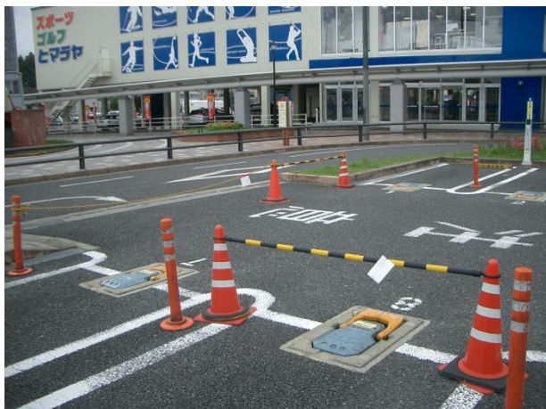
管理システムが破損した福知山駅南口広場駐車場
