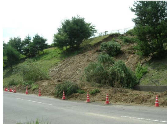
工業団地緩衝緑地被災状況（長田野町）
