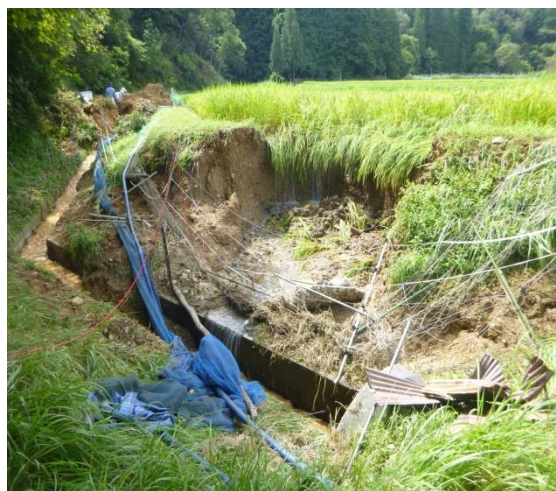
農地等被災状況（榎原地内）
