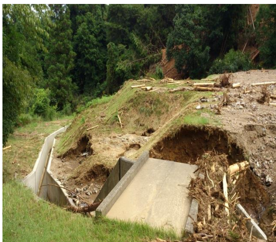
ため池被災状況（荒木地内）
