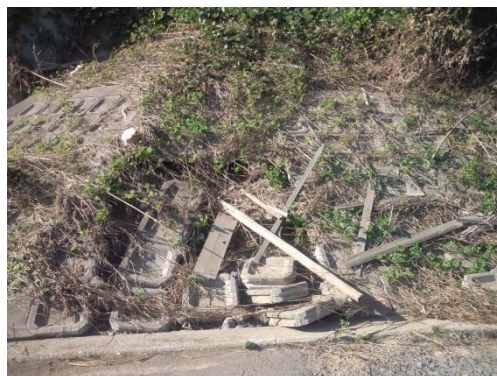
被害状況【軌道法面崩壊(公庄駅付近)】
