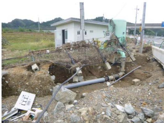
揚水機場被災状況（金屋地内）
