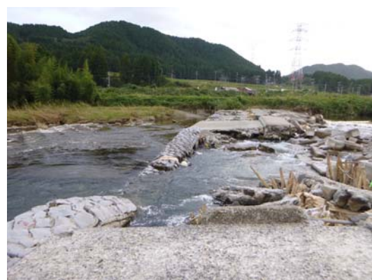
井堰被災状況（猪野々地内）
