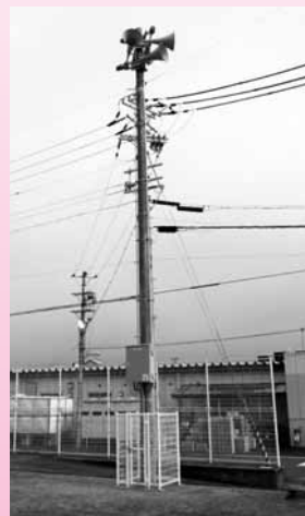
荒河さくら公園(上荒河)に設置した放送設備
