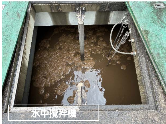
小倉污水处理場
