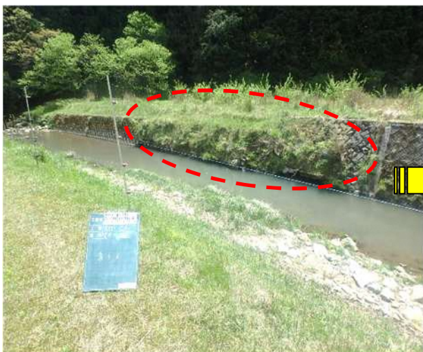
河川護岸が崩れかけており危険
