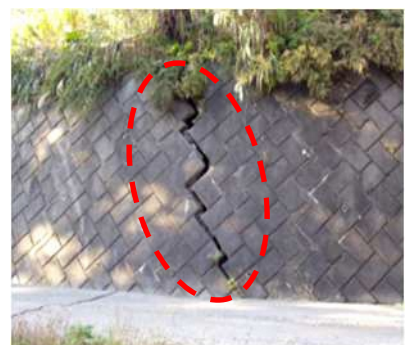
構造物が壊れている
