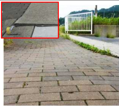
歩道が沈んでいる
