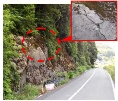
のり面がひび割れている
