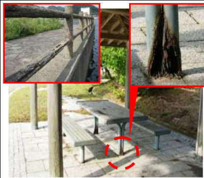
施設が壊れている
