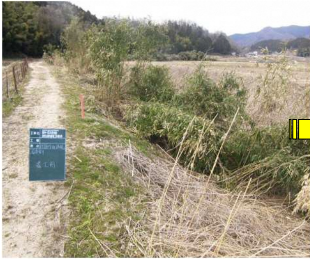
樹木が河川を阻害しており危険
