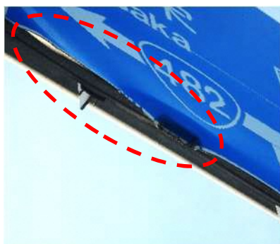
標識板が変形している
