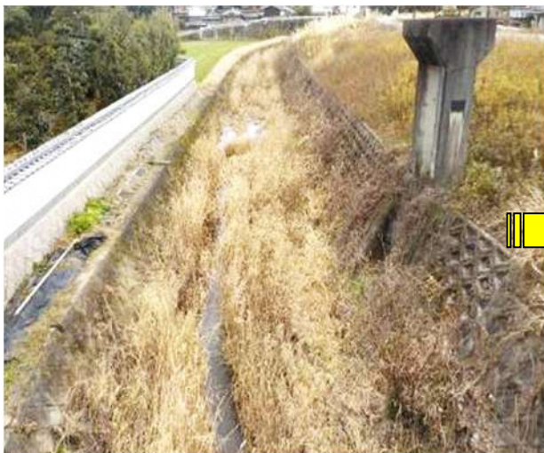
土砂が河川を阻害しており危険
