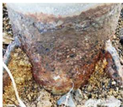
標識柱の根元が錆びている
