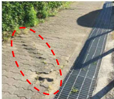
園路に段差ができている
