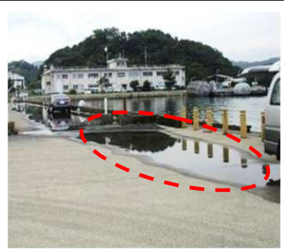
舗装が沈んでいる
