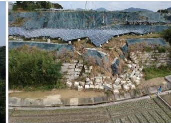
法面保護工が崩れて流出した事例
