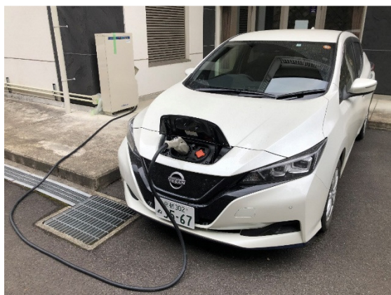
EV 充放電設備 (福知山市武道館)
