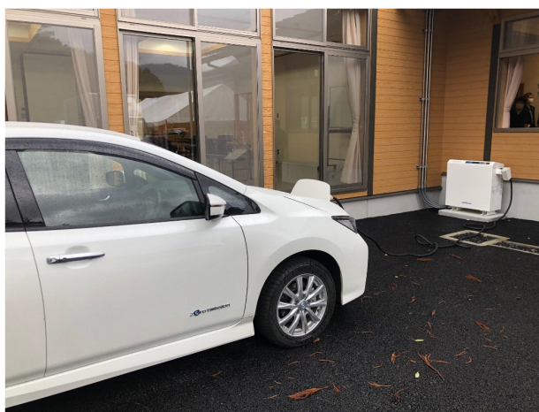
災害等による停電時にも使用可能な V2B システム
