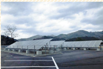
北陵地域公民館の太陽光発電設備
