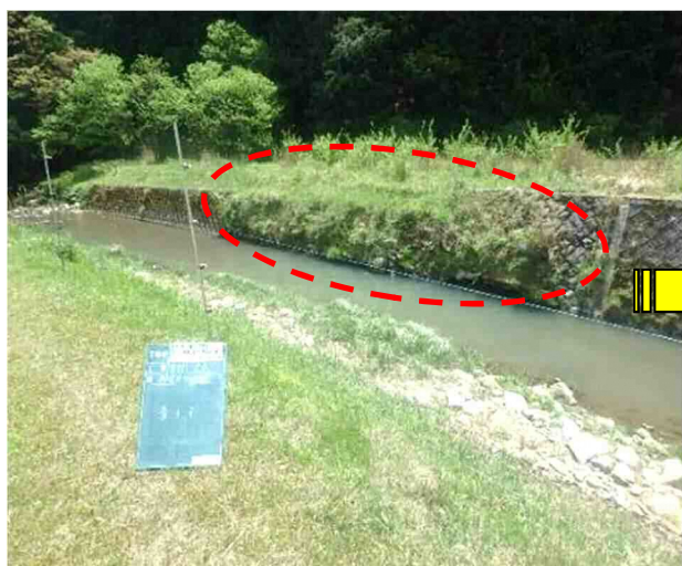
河川護岸が崩れかけており危険
