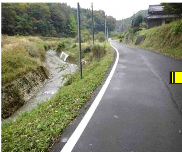
車両などが川に転落しそうで危険
