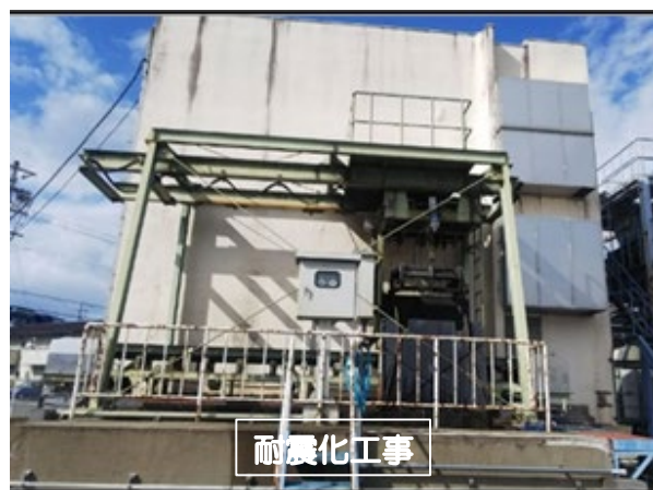
和久市第2ポンプ場
