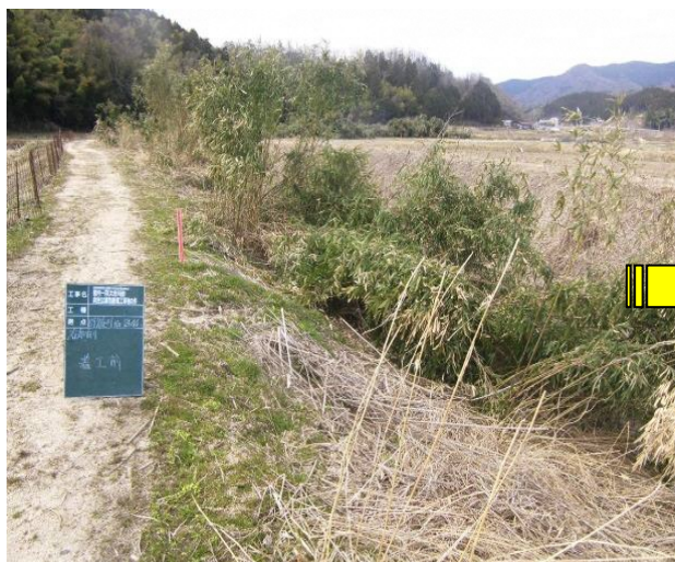
樹木が河川を阻害しており危険
