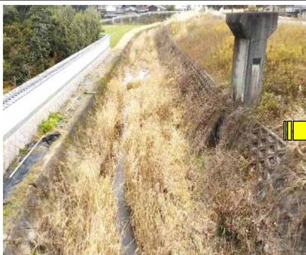
土砂が河川を阻害しており危険
