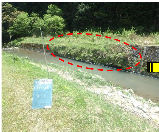
河川護岸が崩れかけており危険
