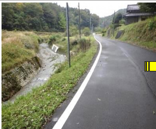
車両などが川に転落しそうで危険
