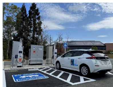
急速充電設備（三段池公園）
