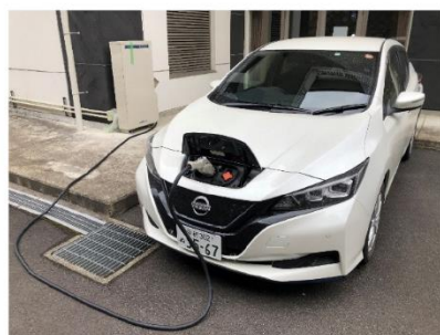
EV 充電設備（福知山市武道館）
