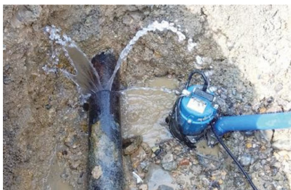
▲古い水道管の漏水
