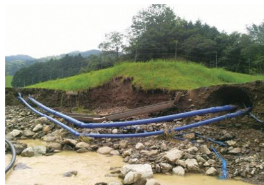
▲道路が被災したが漏水しなかった (耐震管)
