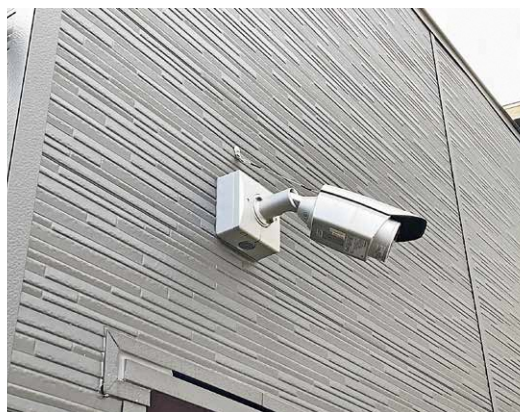
住宅に設置されている防犯カメラ
