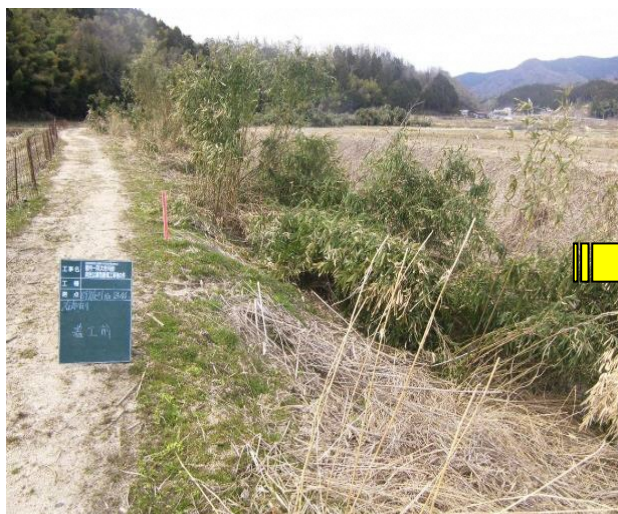
樹木が河川を阻害しており危険
