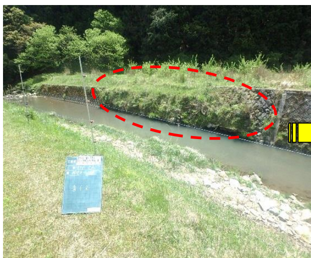
河川護岸が崩れかけており危険
