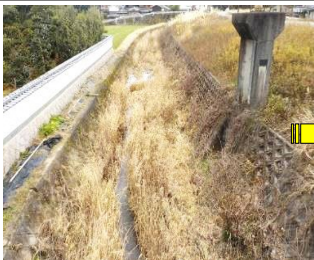
土砂が河川を阻害しており危険
