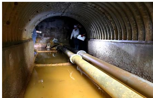
第3坑口内 バルブ等設置導水管
