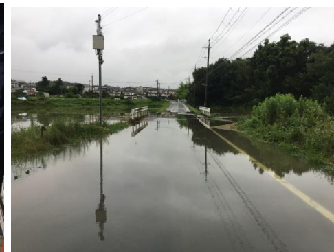
豪雨災害での道路冠水の 状況(H30.7)
