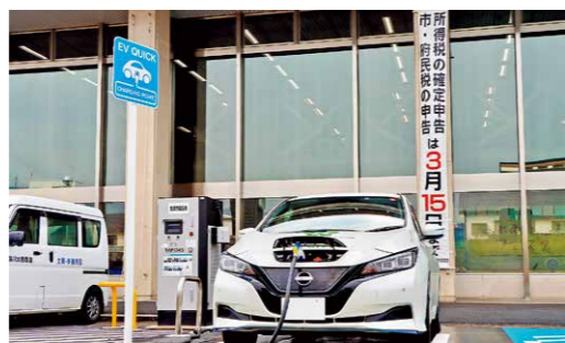
3月1日(金)から運用を始めた市役所庁舎駐車場の電気自動車用急速充電設備。
