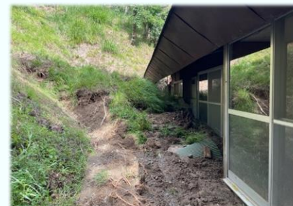
被災した人家裏の林地(南四地区)
