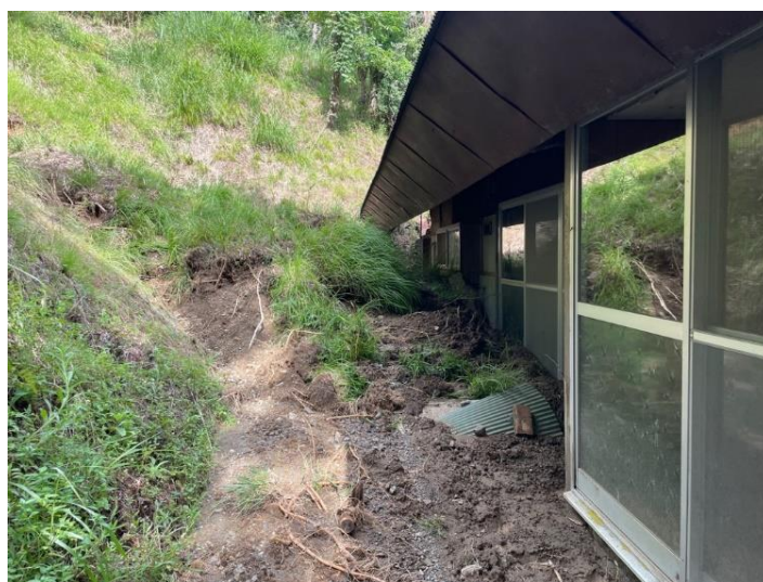
被災状況 (南四地区)
