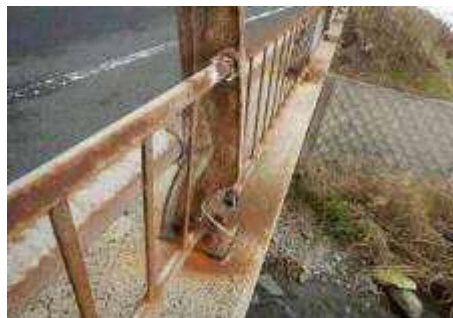
柵が錆びている
