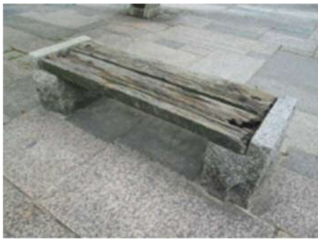
□木製施設が腐っている
