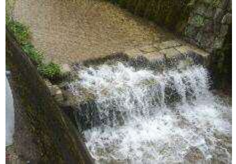
□ 構造物が一部壊れている
