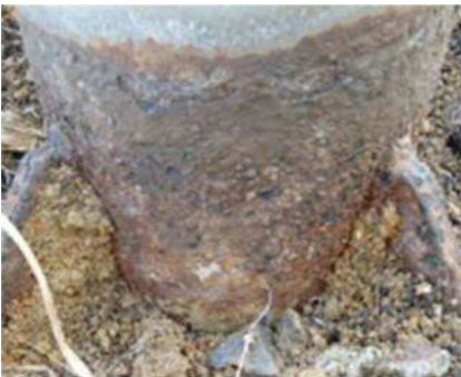
□標識柱の根元が錆びている
