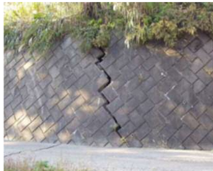
□構造物が壊れている
