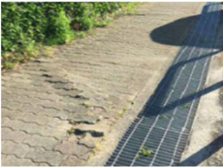
□園路に段差ができている
