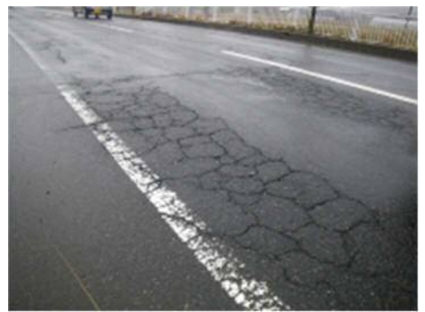
□ 舗装がひび割れしている
