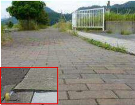
□歩道舗装が沈んでいる
