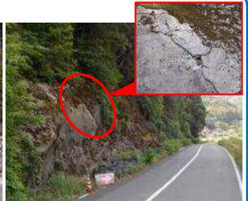
□ のり面にひび割れがある
