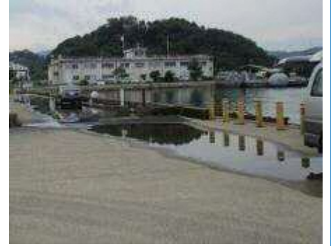
□舗装が沈んでいる
