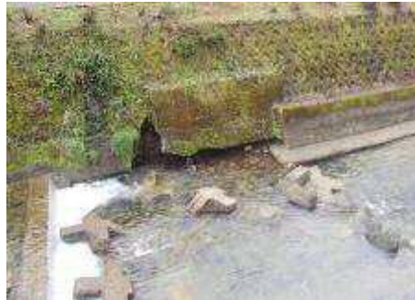
□ 護岸が崩れかけている
