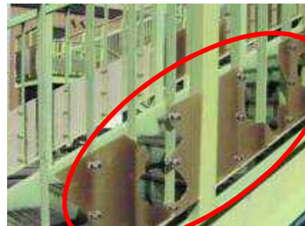
歩道橋のパネルが壊れている
