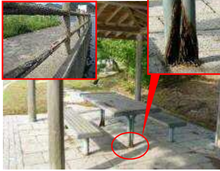
□施設が壊れている
