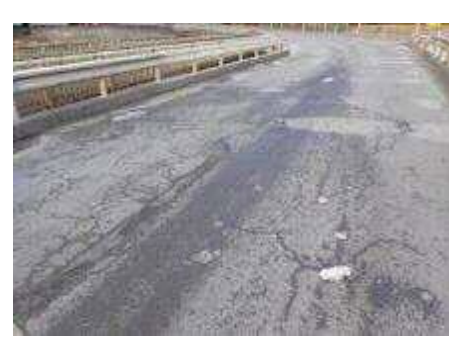
舗装がひび割れしている
