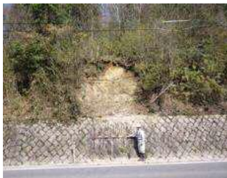
□ のり面が崩れている
