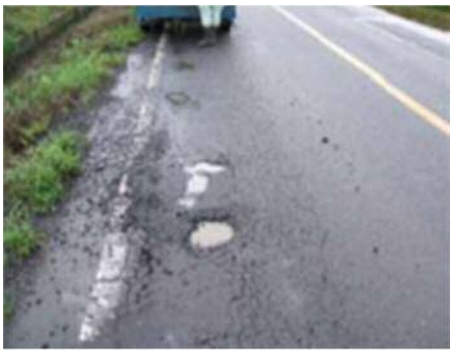
□ 舗装の一部に穴が開いている
