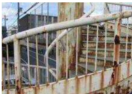
歩道橋が錆びている
