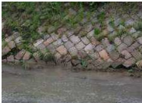
□ 護岸が崩れかけている
