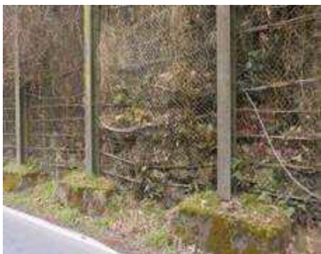
□ 落石を止める網や柵が壊れている
