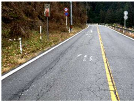
□ 舗装が波打っている
