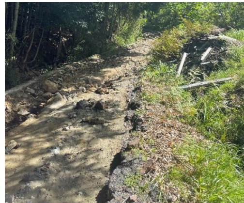
里道の被災状況（行積地区）
