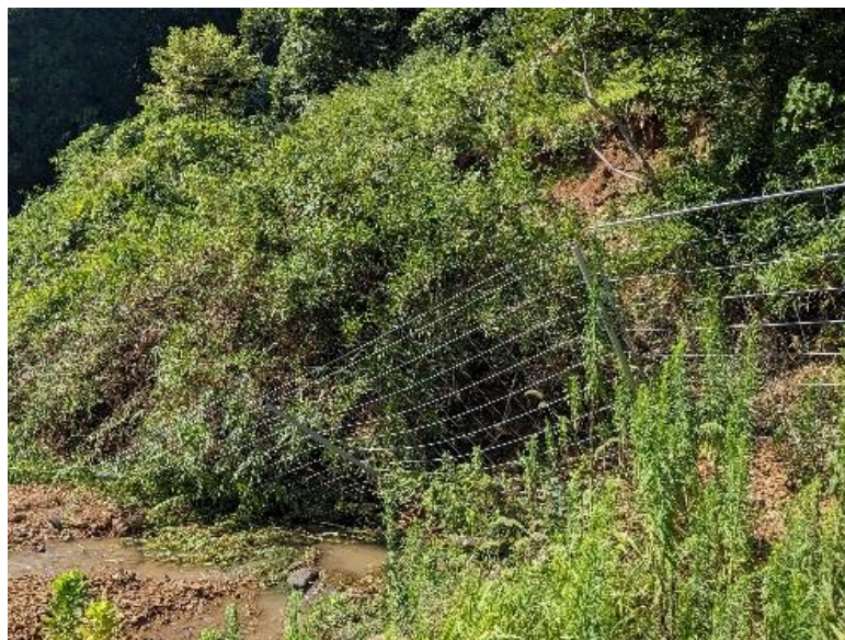
大江町南有路地内 ワイヤーメッシュ柵の被災状況
