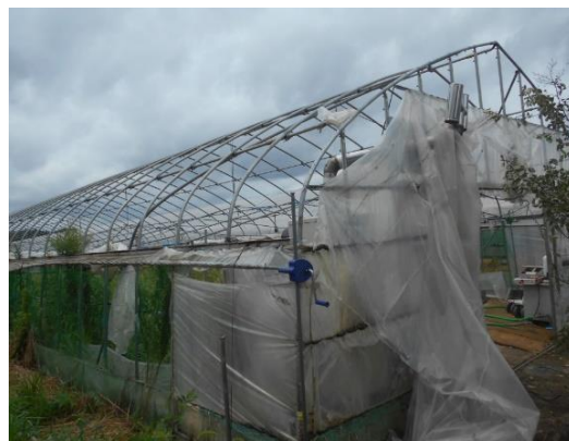
パイプハウスの被災状況
