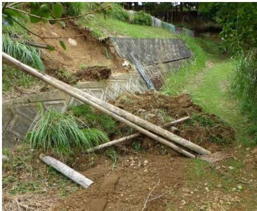
里道の被災状況（小牧地区）
