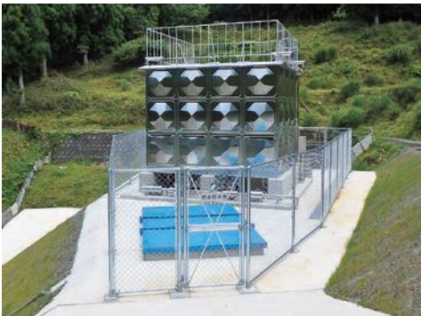
▲ステンレス配水池 (橋谷配水池)
