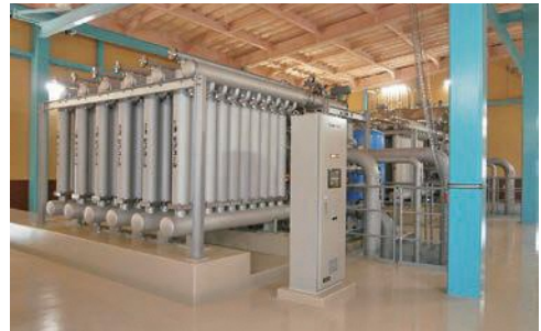
▲現在の堀浄水場膜ろ過施設
