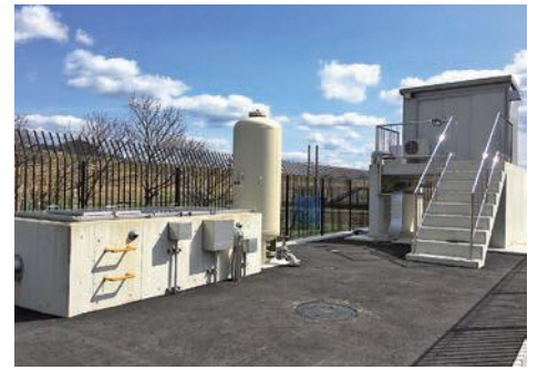
▲波江第4取水ポンプ所完成（平成30年）
