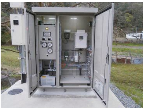
▲水質測定所 (田和水質測定所)
