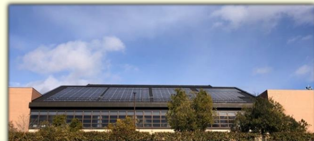
PPAで太陽光パネルを設置した三段池公園総合体育館
