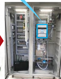
▲扉を開けた様子 左側：電源、通信設備 右側：水質測定器
