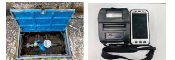
▲水道メーター ▲検針用タブレット
