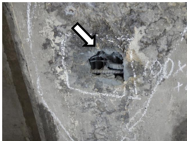
長田野西橋 主桁損傷状況
