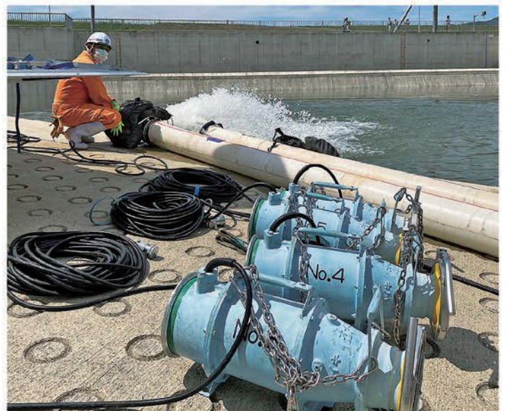
▲排水ポンプの点検や動作確認をしている様子
