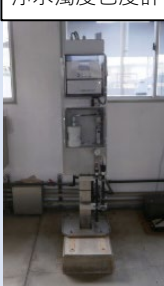
浄水濁度色度計
