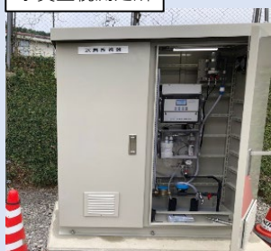
水質監視測定所
