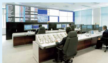
現在の消防指令センター
