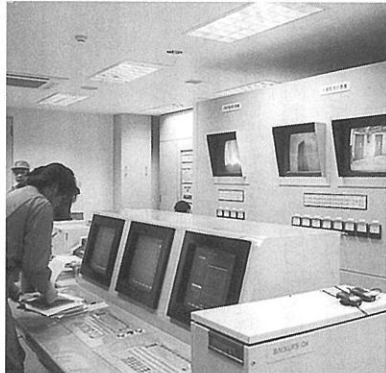
▲稼働に向け、着々と進む燃焼テスト
