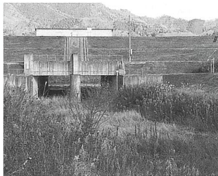
建設省により移動式ポンプの設置が計画される弘法川樋門
