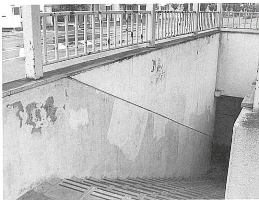
手すりの設置が待たれる北本町地下道
