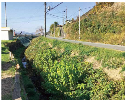
除草が必要な市道の法面
