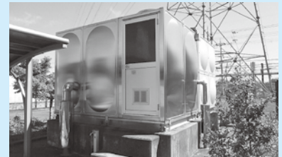
↑ 貯水槽水道（受水槽）
