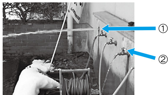
▲①は蛇口が破損し漏水している様子 ▲②はカランが閉まらず漏水している様子
