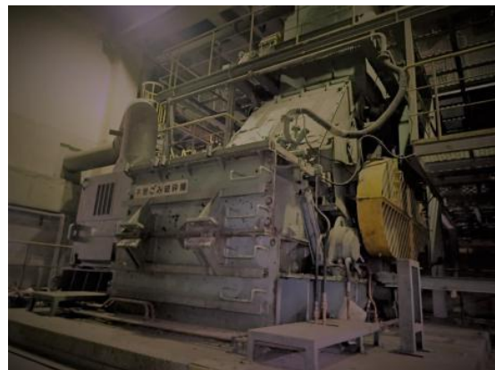
不燃ごみ破碎機現況
