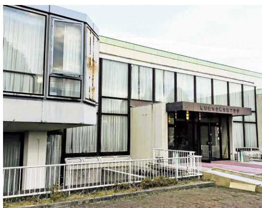
老朽化が激しい企業交流プラザ(長田野工業センター)
