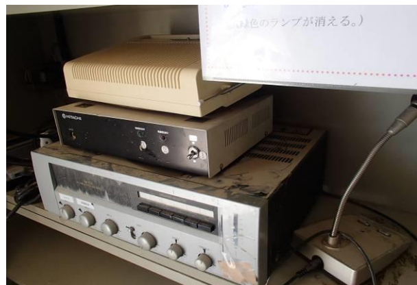
被災した防災行政無線受信機（公民館）
