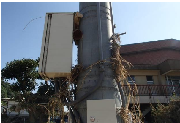
被災した防災無線屋外スピーカー子局
